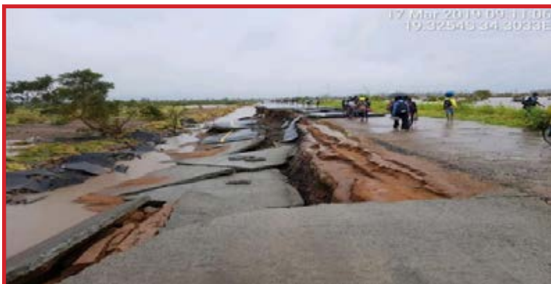
Figura 7: Via de comunicação danificada na Província de Sofala. Fonte: INGC
