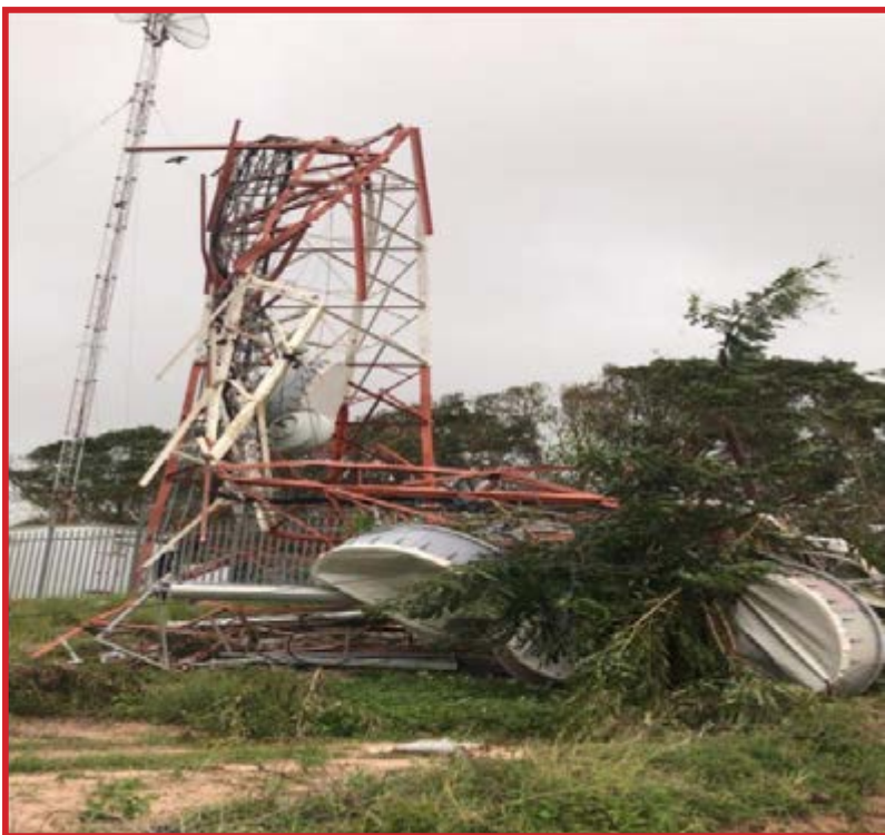
Figura 6: Torre danificada do operador Tmcel na Província de Sofala.
